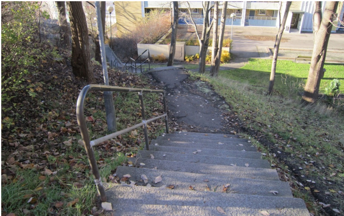
Figur 11 Befintlig gångbana ner mot Slottsskogsgatan. På bilden ses även den bristfälliga beläggningen. Bilden tagen från sydöst.
