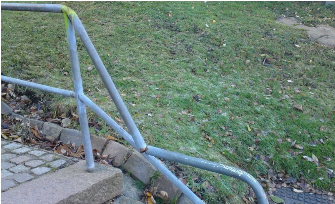
Figur 15 Ett trasigt räcke strax ovanför Toppsegelsgatan.
