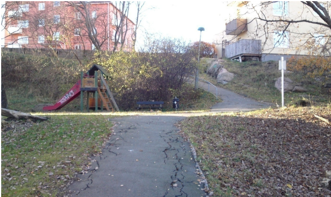
Figur 17 Befintlig gångbana förbi lekplatsen. Asfaltsbeläggningen är ojäm och på många ställen full av sprickor. Bilden tagen från öster.
